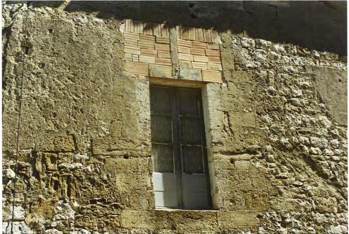
Exemple de mauvaise réhabilitation sur une ancienne fenêtre à meneau.
